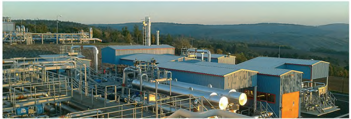
Установка для подземного хранилища газа в Урице, Чехия-2011-2013г.
