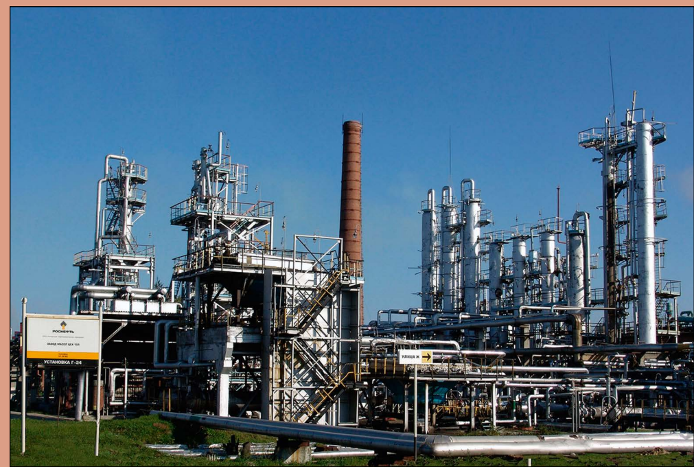
Продукт технологического проектирования – установка гидрокрекинга масел на НПЗ ОАО «Ангарская нефтехимическая компания». Проектировщик – ОАО «ВНИИ НП», ОАО «Ангарскнефтехимпроект».
